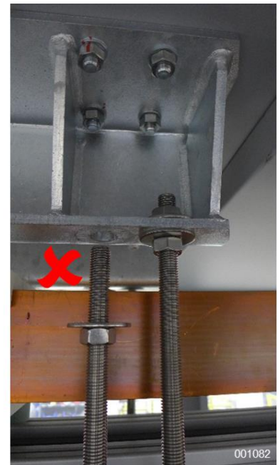
Raccord vissé desserré
