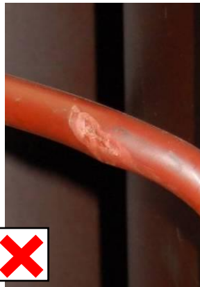
Afb. 11: Niet toegestaan! Vervormde isolatie van een schakelverbinding
